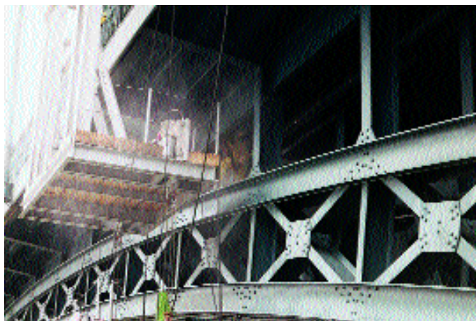
Abb. 8: Reinigungstätigkeiten an einer Brücke zwischen Mainz und Wiesbaden. Die Taubenkotverunreinigungen wurden mit Hilfe von Hochdruckreinigern (100 bar Druck, 95° C) entfernt. Deutlich sichtbar ist die dabei entstandene Aerosolwolke. Im linken Bildteil ist eine begehbare Arbeitsplattform zu sehen
