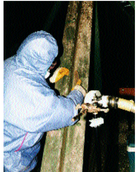
Abb. 13: Reinigungstätigkeit an einem durch Taubenkot verschmutztem Stahlträger. Die Verschmutzung wird mit Hilfe einer Drahtbürste entfernt. Der Atemtrakt des Arbeitnehmers ist weniger als eine Armlänge von der Verschmutzung entfernt. Rechts ist ein Probenahmekopf eines MD 8-Luftkeimsammlers zu sehen
