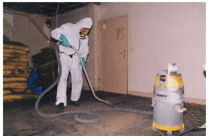
Abb. 14: Reinigungsstätigkeiten mit einem K1-Industriestaubsauger in einem mit Taubenkot verschmutztem Gebäude in Berlin. Tauben hatten seit etwa 1993/94 keinen Zugang mehr zu den Räumlichkeiten
